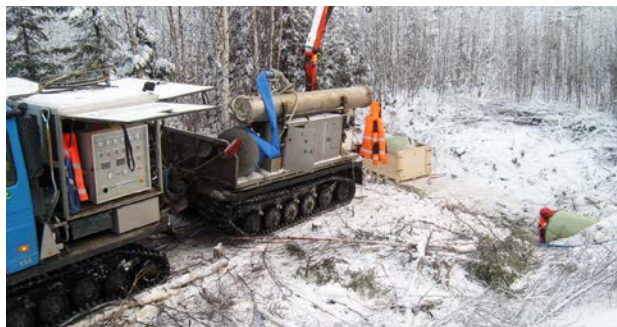
INSTALLATIONSUTRUSTNINGEN FRAKTAS PÅ EN BANDVAGN MED LÅGT MARKTRYCK. DÄRFÖR KAN RENOVERING SKE OBEROENDE AV AVSTÄNGDA SPÅR.
