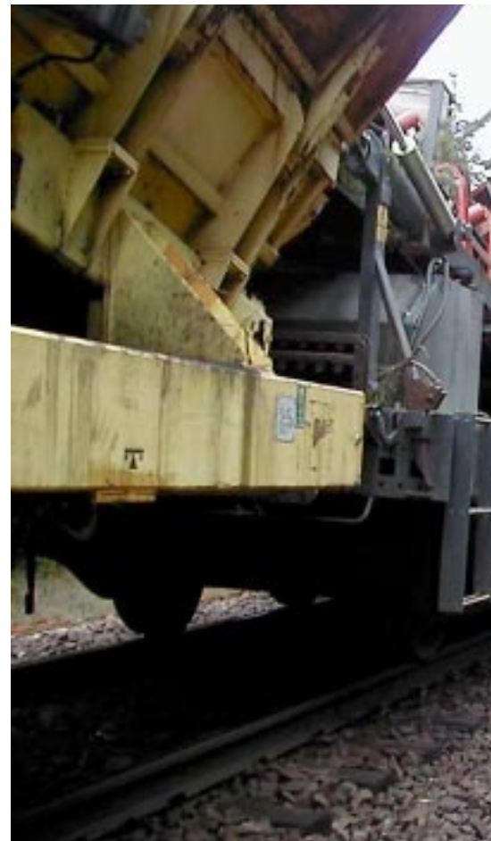
Små träd och buskar skyfflas upp och och förs in i silovagn. Borttagning av ballastöverskott kan göras i samma
